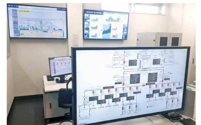
E YOKOGAWA 製品を使用した計測・制御が見られるエネルギー棟
