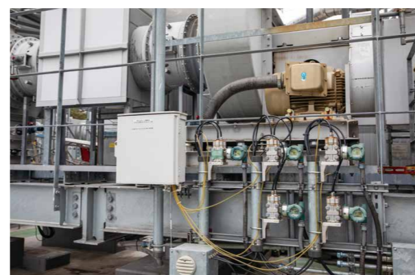
B 伝送器による排気圧力監視・制御
